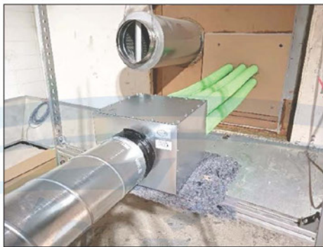
Imágenes 1 y 2 Detalles de la caja de distribución metálica y de su instalación
