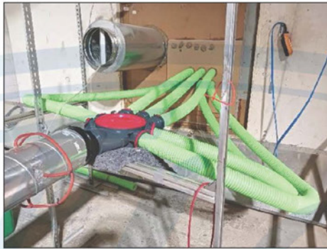
Imágenes 5 y 6 Detalles de la caja de distribución de plástico y de su instalación
